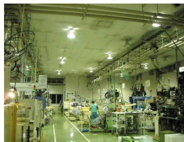
モールド棟： 水銀灯からセラミックメタルライトに 変更し間引き点灯による省エネ
