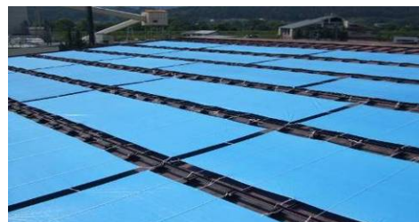
(株)しなの富士通 工場屋根に遮熱シートを貼ることによる省エネ
