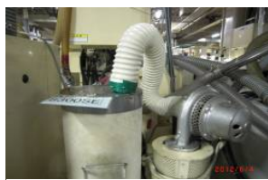
廃熱の室外排気による 冷房負荷低減 株しなの富士通
