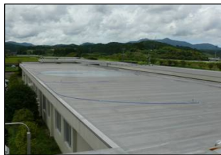
屋上への散水による空調効率の改善
