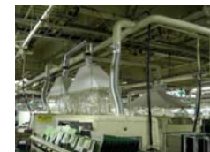
装置強制排気による冷房負荷低減 (株)しなの富士通
